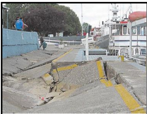
Figura 10. Destrucción muelle Schuster por efecto del terremoto 2010
