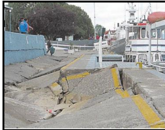
Figura: Destrucción muelle Schuster por efecto del terremoto 2010
