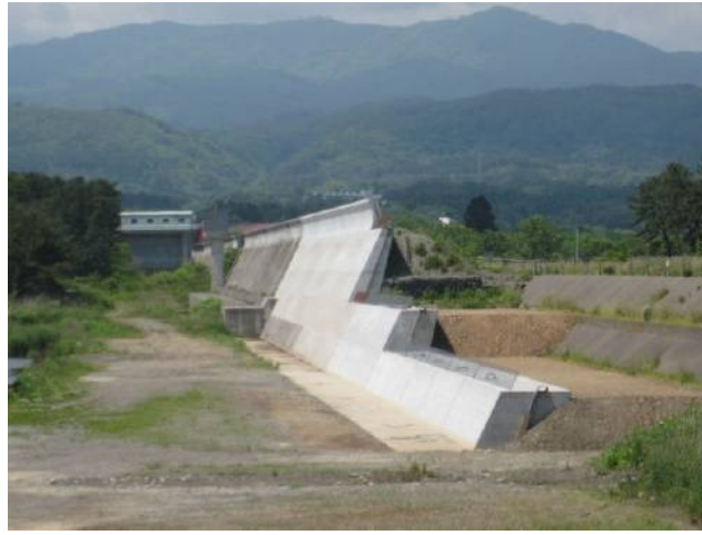
Figura 45. Terraplén en Noda, Iwate, Japón.
