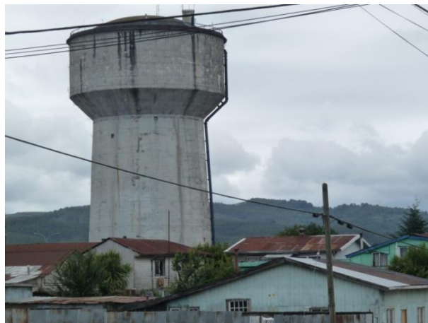
Fotografía N°12. Estanque de regulación en Avda. Picarte. Fuente: LPT-UCT 2014
