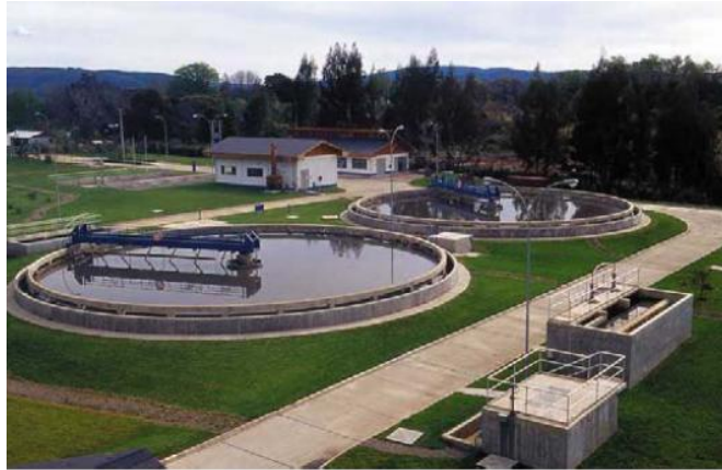
Fotografía N° 11. Estación Depuradora de Aguas Servidas. Fuente: LPT-UCT, 2014
