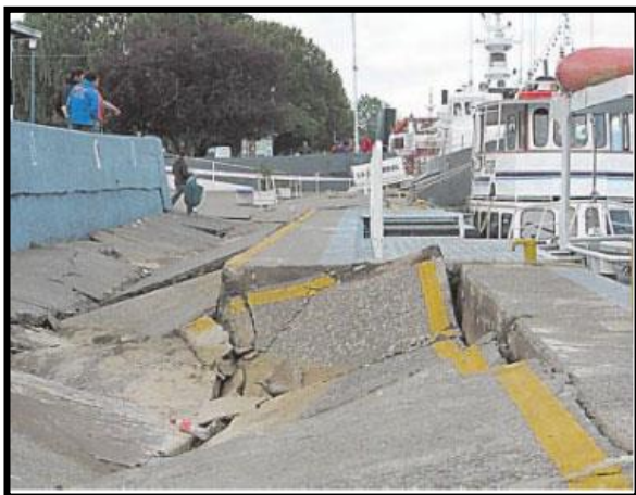
Figura 10. Destrucción muelle Schuster por efecto del terremoto 2010
